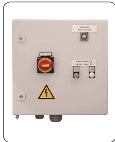
Bild 5 Netzanschluß über den Schaltschrank
