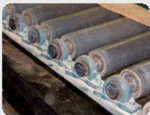
Перегрев подшипника конвейера
